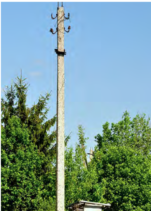
Bezdrátové elektrické vedení, foto: Tomáš Kubeš
